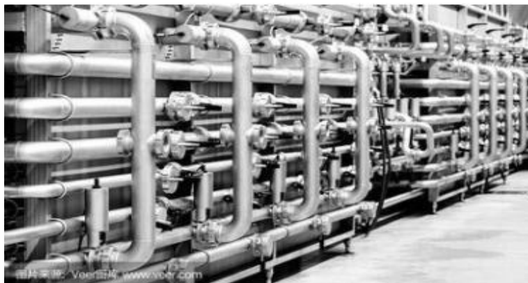
图 1 水电厂机电设备运行图例
